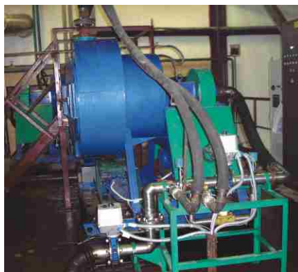
Рис. 1. Система из двух концентраторов ИТОМАК-КГ-30 с автоматическим управлением (ОАО «Уралэлектромедь», Зареченская ОФ, ОАО «Сибирьполиметаллы»)
