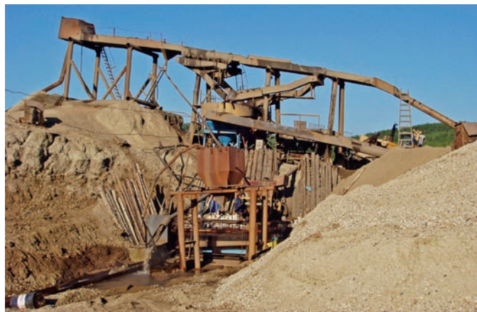
Общий вид этажерочного промприбора со шлюзо-отсадочной технологией обогащения
