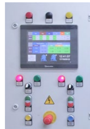
Панель управления автоматикой
